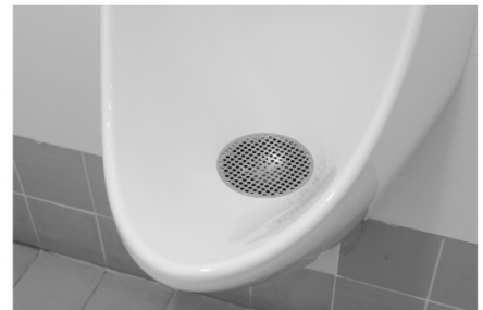
排水口は未使用時密閉されている為、悪臭が逆流してこない。
